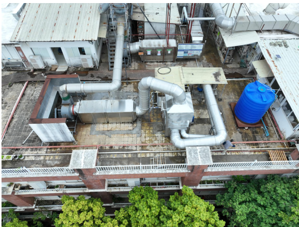
自动喷改造后废气处理设施图
