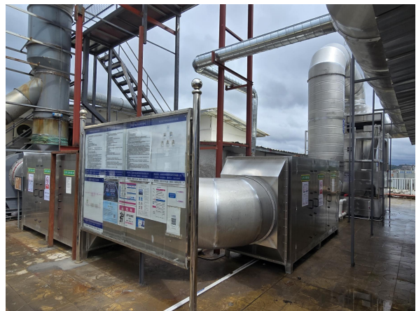
手喷柜改造后废气处理设施图
